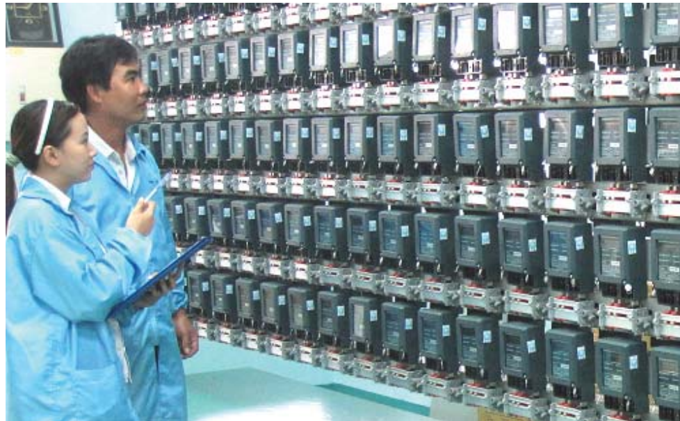
Dây chuyền sản xuất công tơ điện tử
